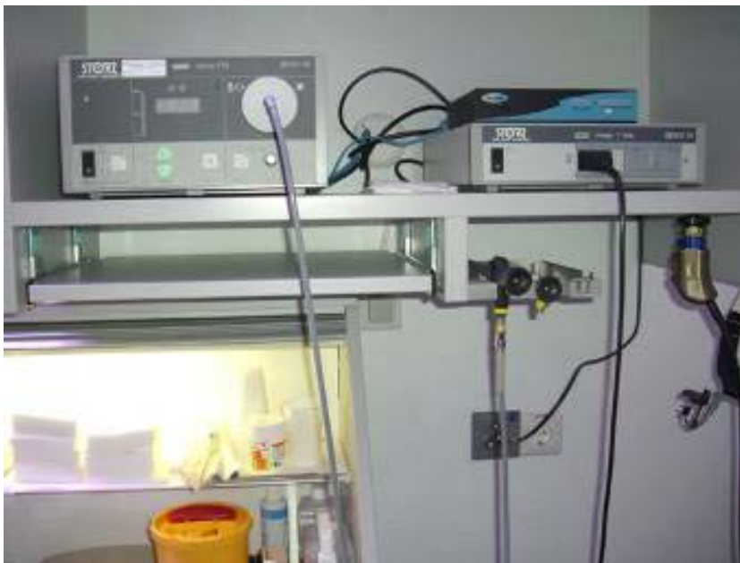
Storz-Geräte in Eschbach-Schrank
